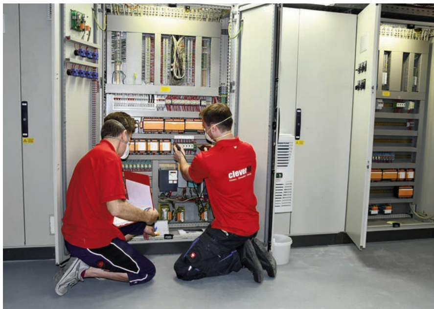
Trotz Schließung: Im Bulmare sorgen u.a. die Haustechniker Daniel Bayer und Andreas Beck dafür, dass die technischen Anlagen einwandfrei laufen und eine rasche Wiedereröffnung des Bades möglich ist.
